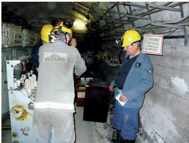
Экспертиза промышленной безопасности высоковольтных ячеек. Рудник «Комсомольский», Заполярный филиал ОАО «ГМК «Норильский Никель»
