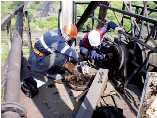
Дефектоскопия оси копрового шкива клетового подъема. ОАО «Поляны», г. Киселевск
